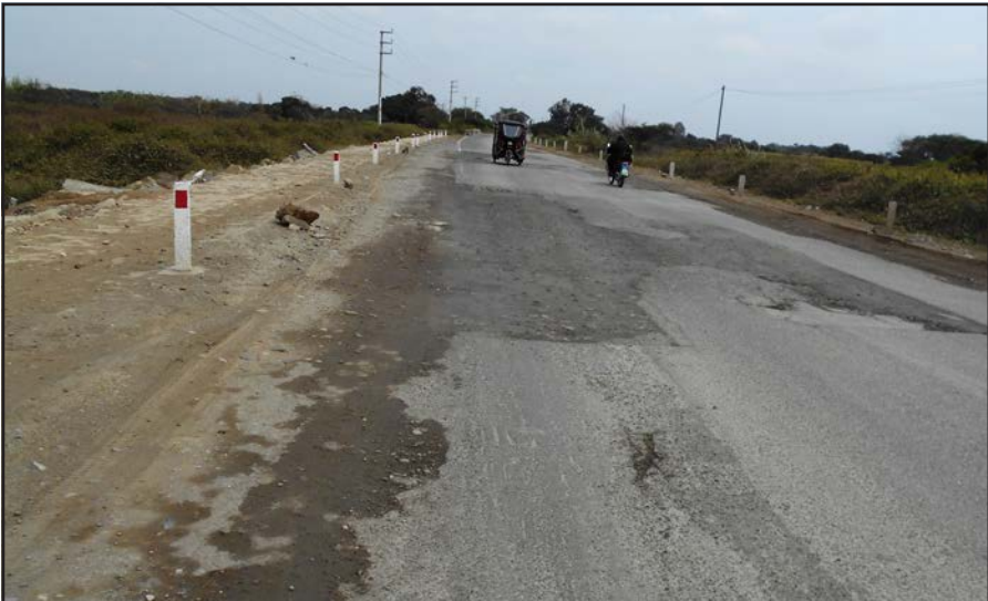
El asfalto, la señalización horizontal y la berma fueron afectados por el desborde del río.
