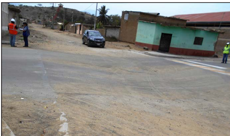
La cuneta cumplió la función de derivar el torrente de agua de lluvia y piedras hacia otras zonas fuera de la vía.
