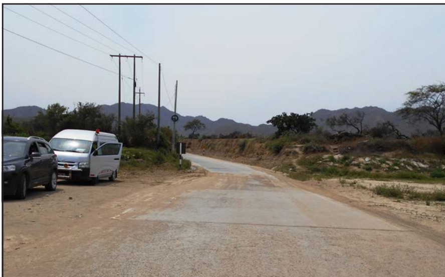
La infraestructura presenta desgaste por abrasión, como consecuencia del huayco que pasó por el lugar.
