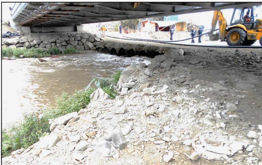
Batería de alcantarillas instaladas posteriormente al fenómeno El Niño Costero.
