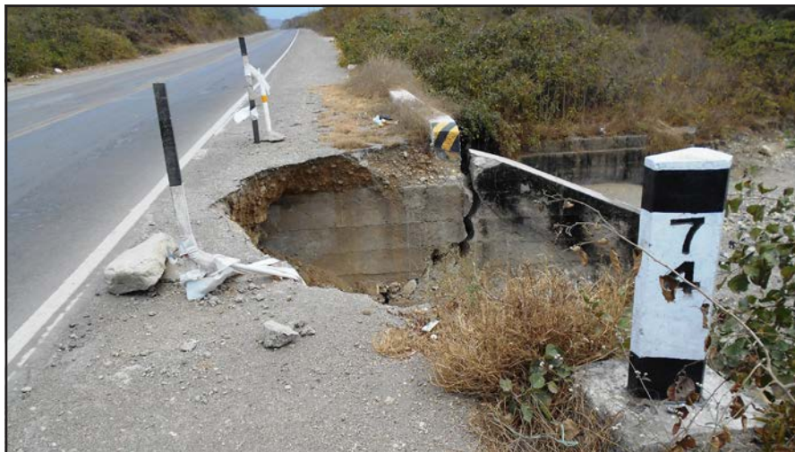
Km. 70 al 79 (Motupe): Las bermas se encuentran en mal estado por tramos.
