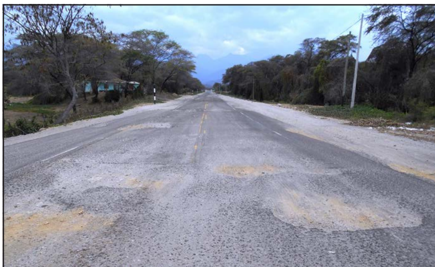
La vía es transitable, pero las dimensiones de los baches vuelven la circulación lenta e insegura para el tránsito de noche.
