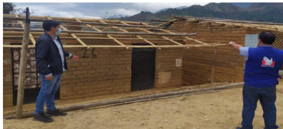
Verificando las viviendas afectadas por los vientos fuertes Fuente: Defensoría del Pueblo.
